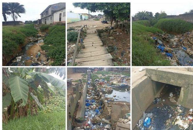
Photo 3 : Canal en terre envahi par des ordures et végétations
