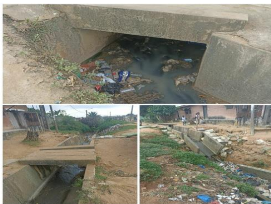
Photo 1 : Canal existant encombré par des ordures
